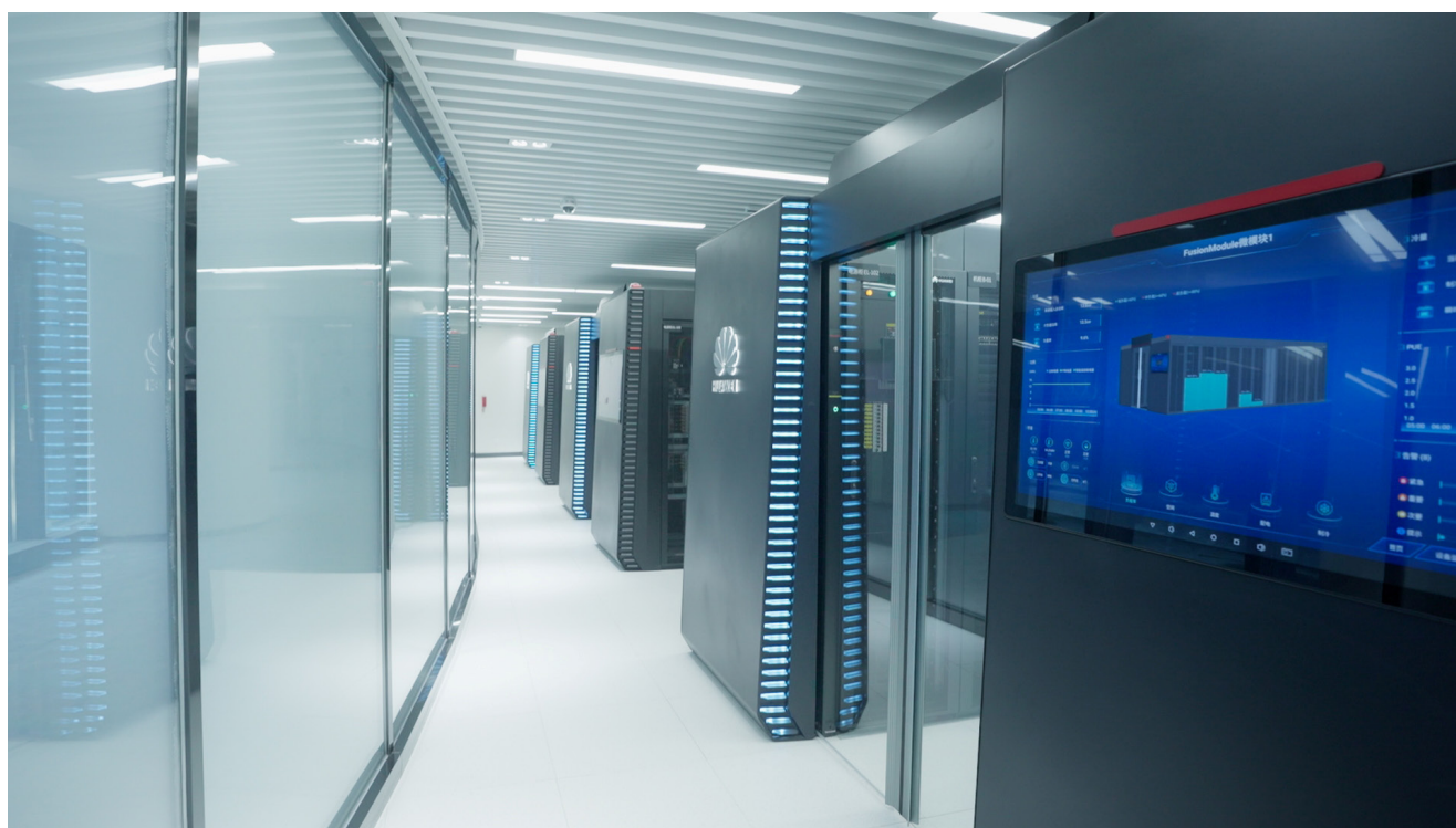
Seres Data Center
